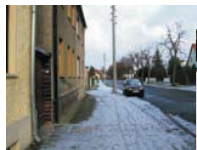
Gehweg an der Hermann-Kasten-Straße vor dem Ausbau, teilweise unbefestigt
