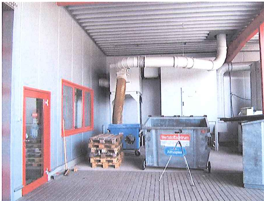
Bild 12: Absauganlage 1 (Standort: unter Vordach – Produktionshalle 1)
