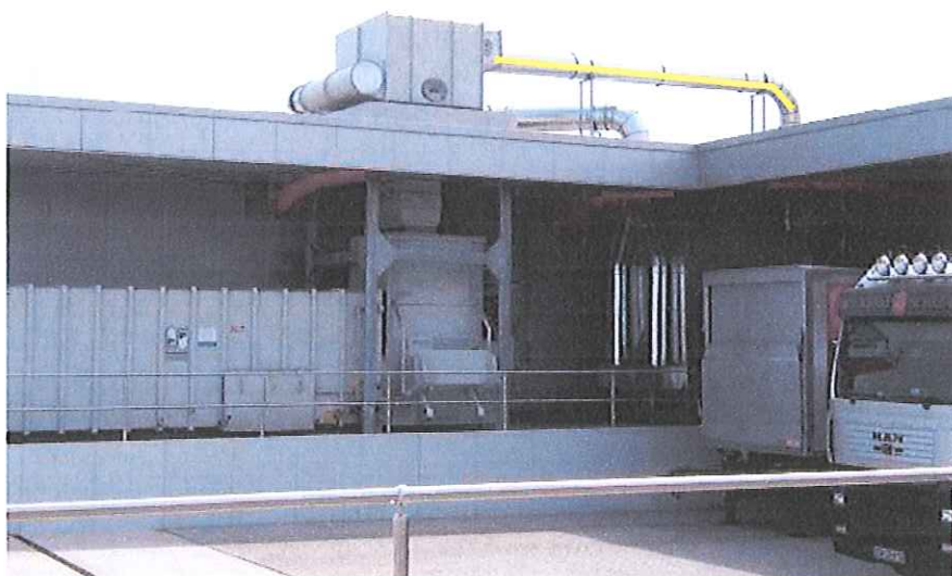
Bild 13: Absauganlage 2 (Standort: auf dem Dach und unter Vordach – Halle 2)
