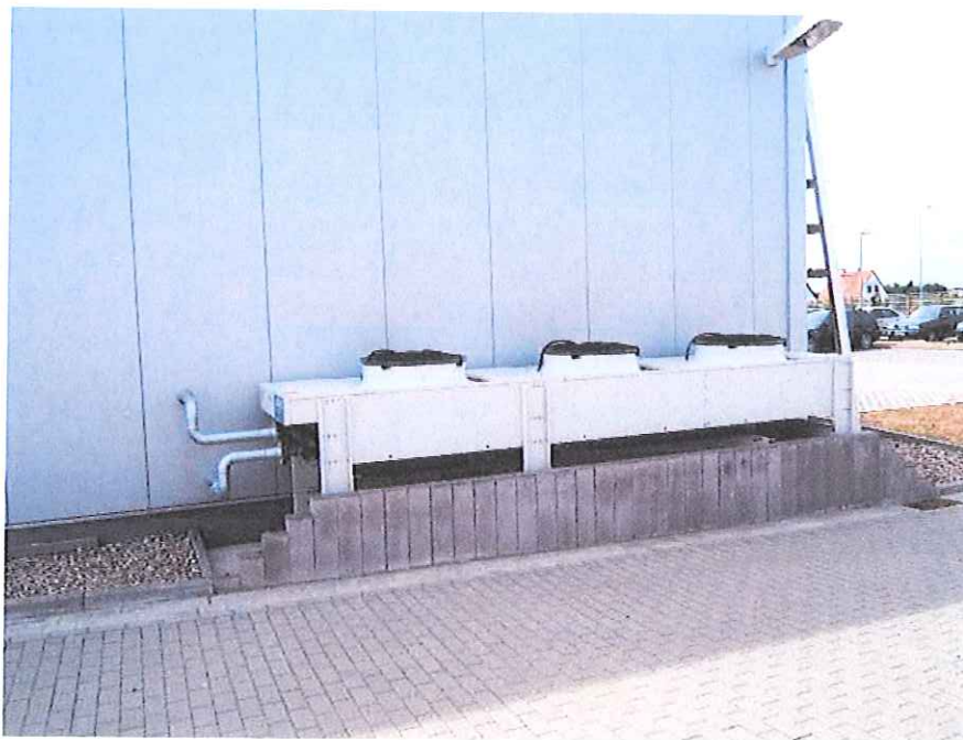
Bild 16: Tischkühler (Standort: vor Halle 1, Nordseite – Produktionshalle 1)
