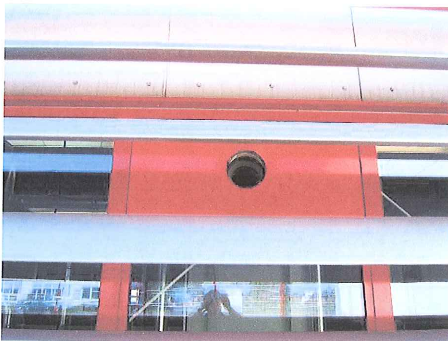
Bild 17: Abluft Klebebinder (Nordostfassade – Produktionshalle westl. Grundweg
