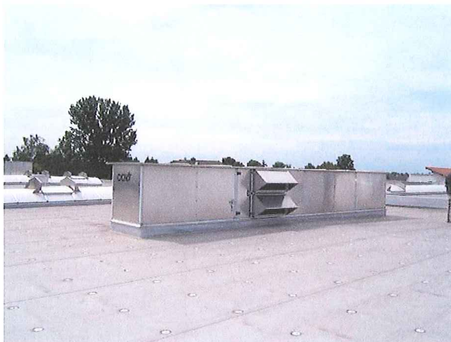
Bild 14: Lüftung 1+2, Klima 1 (Standort: auf dem Dach – Produktionshalle 3)
