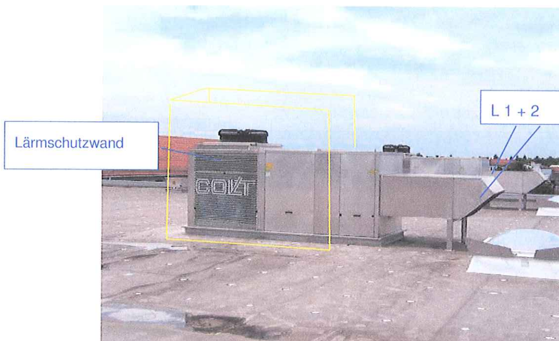
Bild 10: Lüftungsanlagen 1+2 (Standort: auf dem Dach – Produktionshalle 1) mit ange- deuteter Lärmschutzwand (vgl. Pkt. 5)
