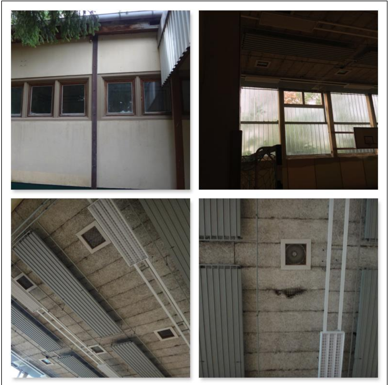
Abbildung 26: Schwachstellen Waldschule Elbenau Turnhalle
