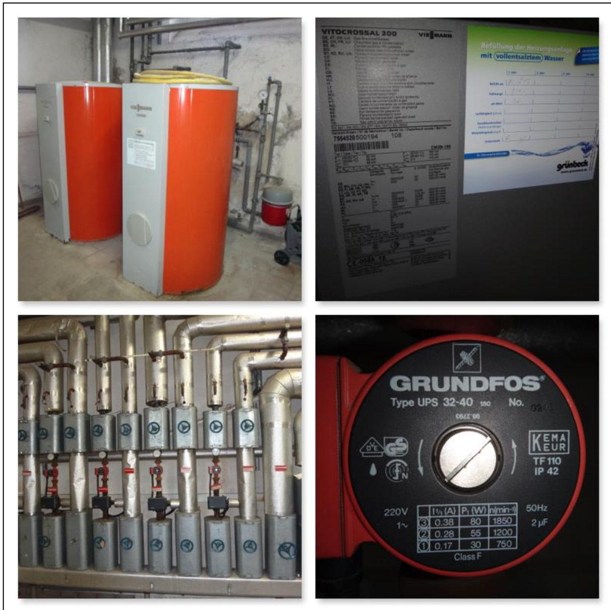
Abbildung 21: Anlagentechnik Karl Liebknecht Schulgebäude und Turnhalle
