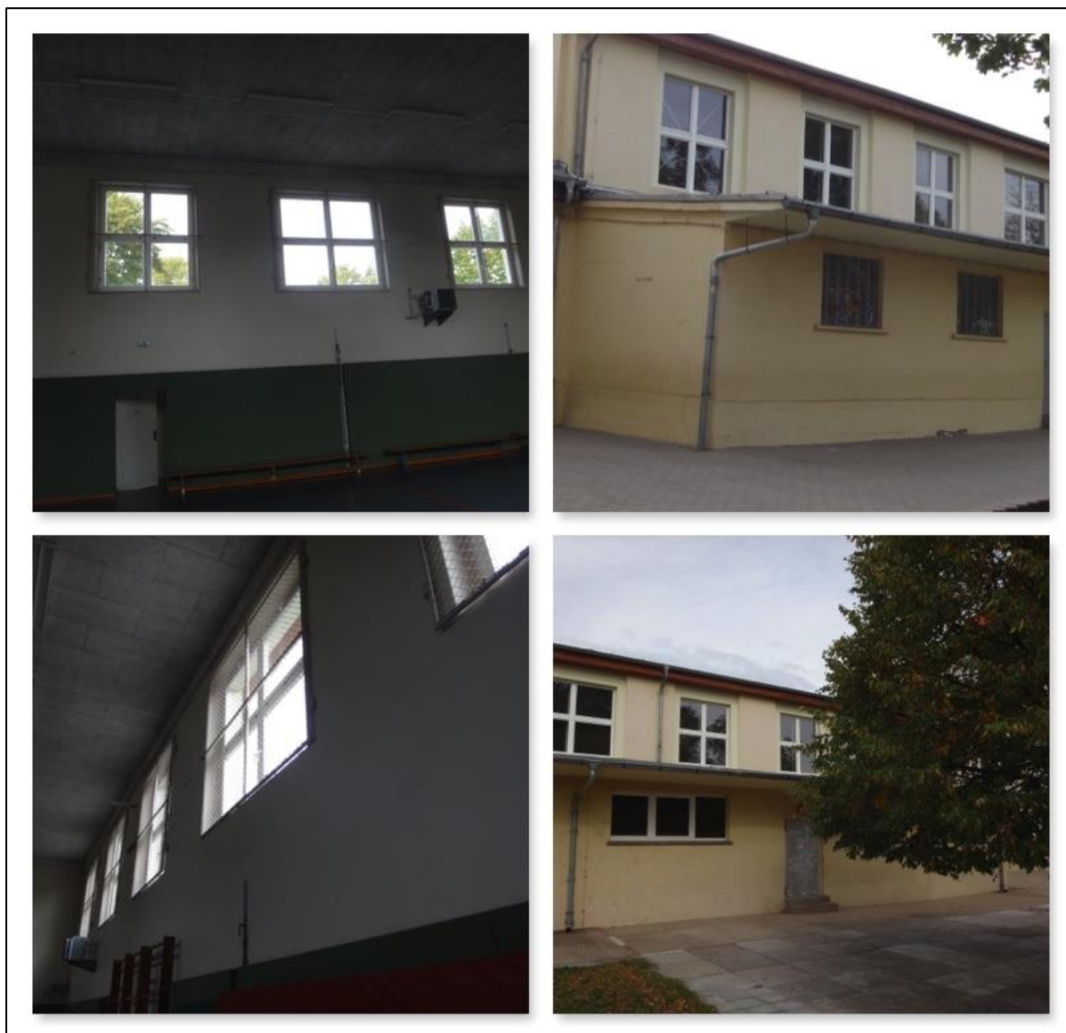
Abbildung 24: Schwachstellenübersicht Karl Liebknecht Turnhalle
