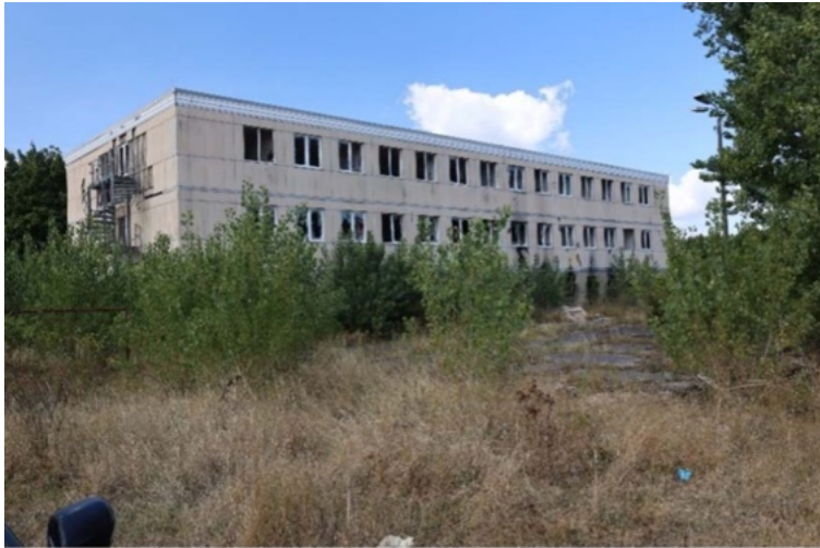
Ausprägung des verwahrlosten Zweckgebäudes im westlichen Teil des Geltungsbereiches 24
