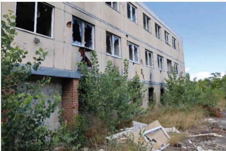
Starke Vermüllung und Verwahrlosung im Umfeld des Gebäudes 31
